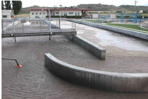
Figura 6.28 EDAR de Tàrrega. Iagua
