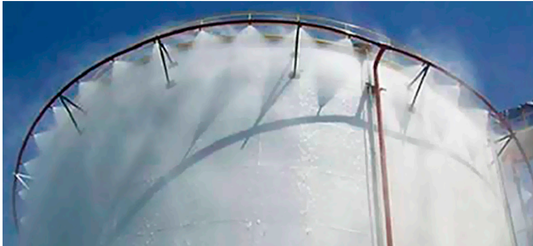
Figura 5.18: Rociadores en acción en la zona perimetral de un tanque
