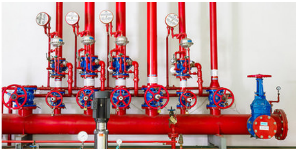
Figura 5.14: Puesto de control y Sprinklers
