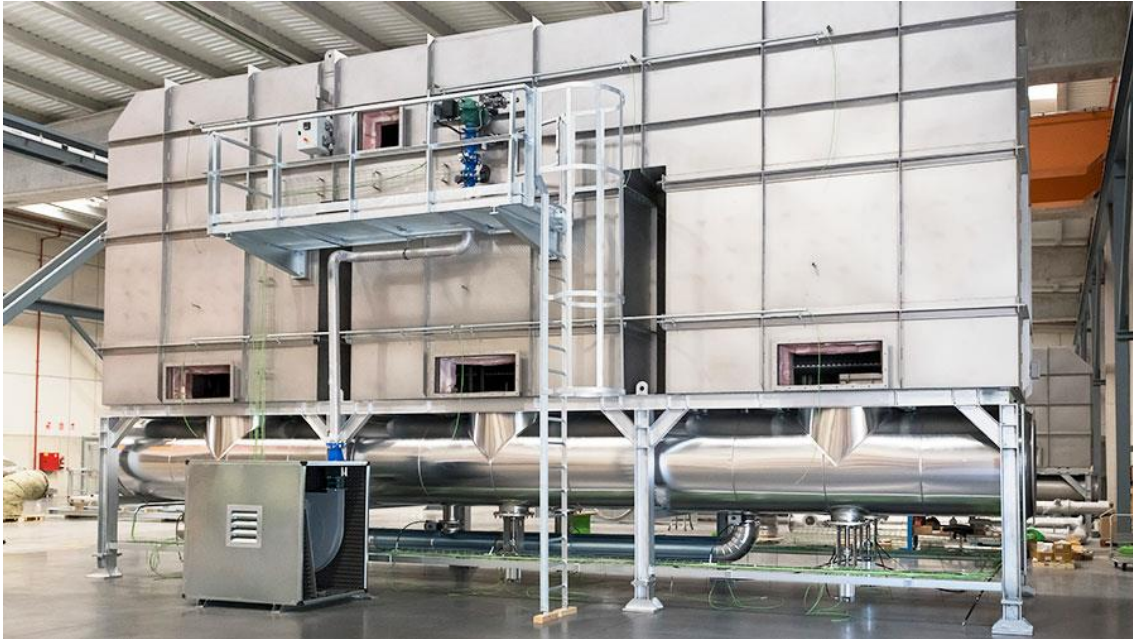
Figura 6.12. Oxidador tèrmic regeneratiu (RTO)
