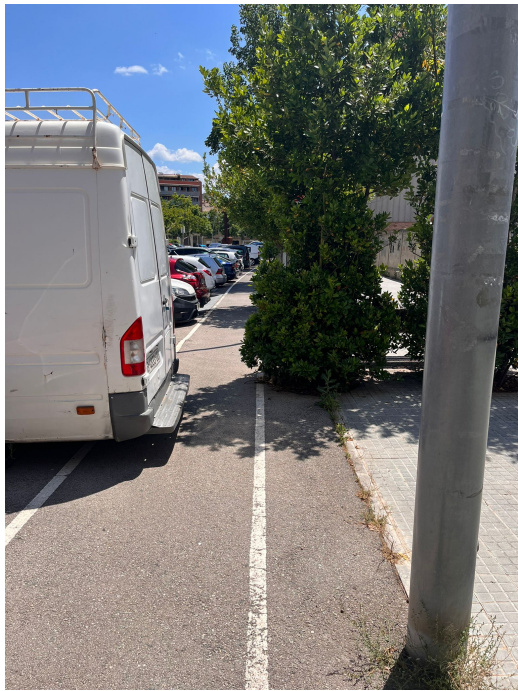
Fig. 14: Mal estat del carril bici, carrer de la Font del Gat Font: Elaboració pròpia
