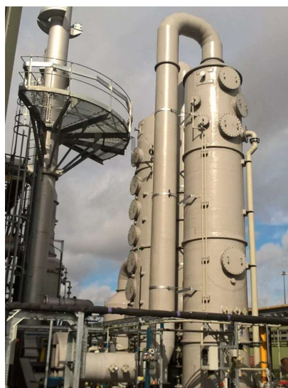
Figura 2.7: Torre d'absorció industrial.
