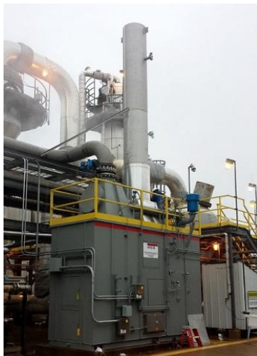
Figura 6.14 CatOx compacte tipus skid de l'empresa Anguil.
