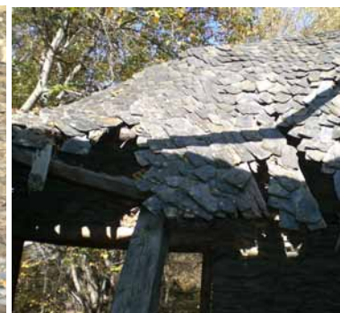
Imatge 4: Detall de la teulada degradada del corral batedor.
