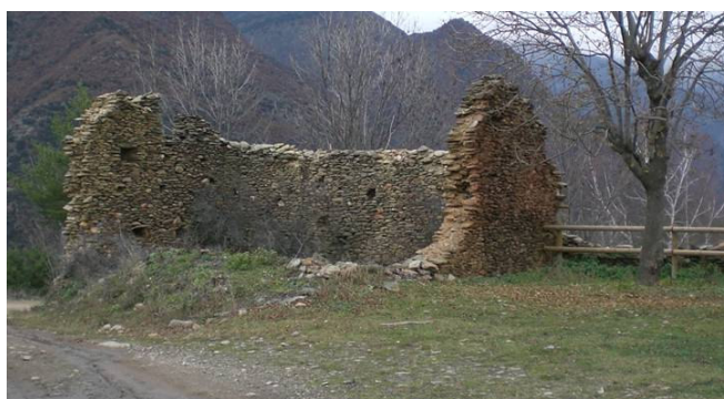
Imatge 5: Estructura enrunada de la Borda 2
