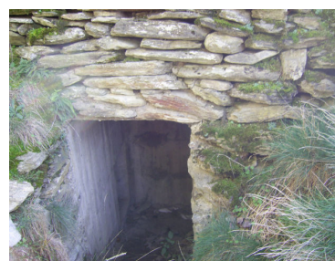
Figura 71. Imatge de l'entrada d'un dels búnquers de la zona de la mollera d'Escalarre.
