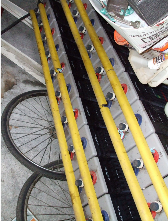
FIGURA A.III.8.23. Acumuladors del sistema d'energia fotovoltaica del Refugi dels Minairons. Font: Elaboració pròpia
