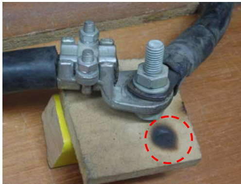
Fotografía 6.11 – Carbonización resultante del calor generado por una deficiente presión en la unión de dos conductores
