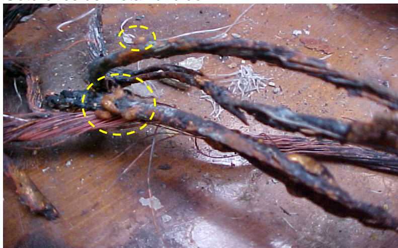
Fotografía 6.6 – La elevada carga térmica presente en el escenario del incendio provocó la fusión parcial del cobre. Obsérvense los goterones de cobre (resaltados en amarillo) generados por su fusión parcial.
