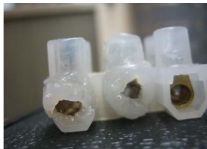
Fotografía 6.12 – Deformación causada en una regleta de plástico como consecuencia de un defecto de presión en la fijación de los conductores
