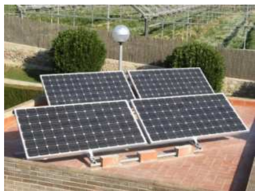
Figura 1.11: Imatge de les plaques fotovoltaïques al sostre de l'habitatge.
