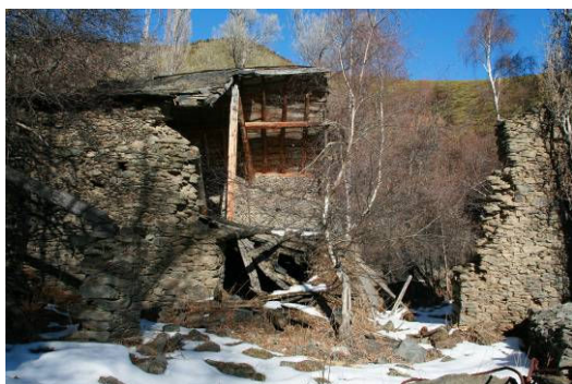
Imatge 7.10.1: Paret sud de la borda on s'observa el 50% en peu i el 50% restant a terra
