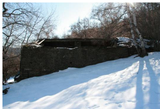
Imatge 7.12.2: Paret nord de la borda. Vista de la teulada caiguda
