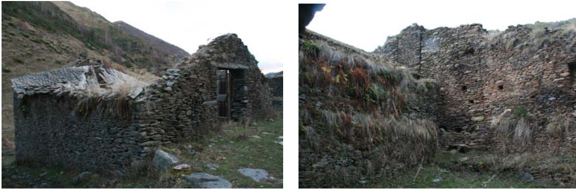
Imatges 9.1 i 9.2: Borda en avançat estat de degradació coberta de vegetació de prat.
