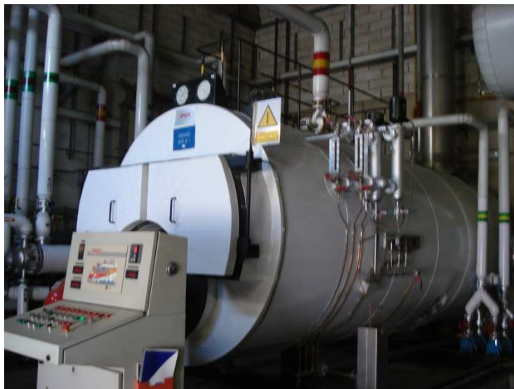
Figura 1.9 . Generador de vapor.
