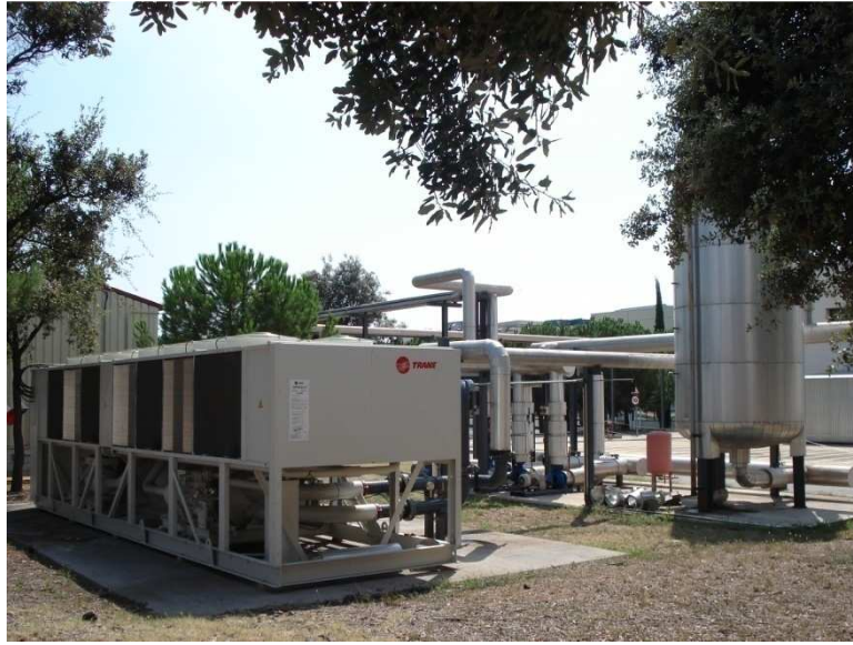
Figura 1.2. Chillers (equips de fred).
