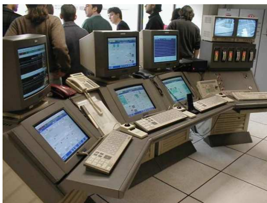
Fig. 3.3. Imatge típica d'una sala de control
