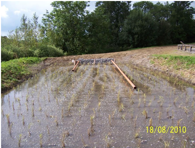
Fotografia 9: Aiguamoll construït d'aeració forçada; National Botanic Garden of Wales. Font: ARM.
