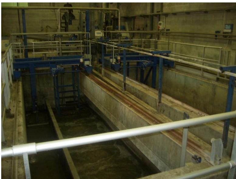
Fotografia 3: Desarenadors del pretractament. Font: pròpia.
