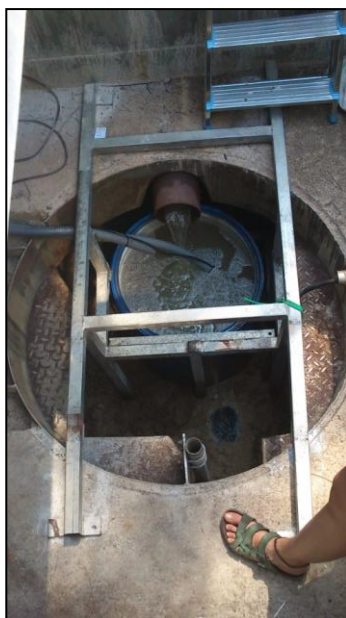
Figura 3. Muntatge per agafar l'aigua residual inicial. Font: Elaboració pròpia.
