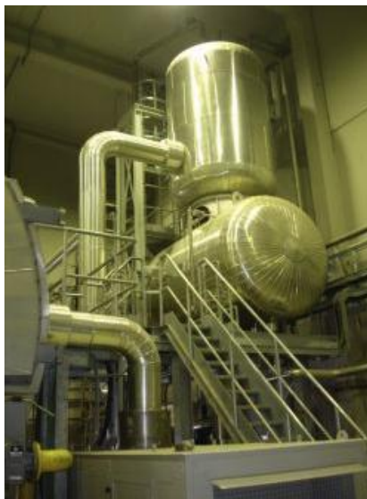
Figura 1.7.10. Depósito de condensados
