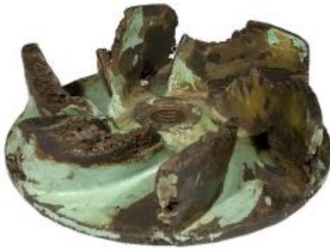
Figura 4.4.1.1.14 Danys causats a una bomba degut a la cavitació.
