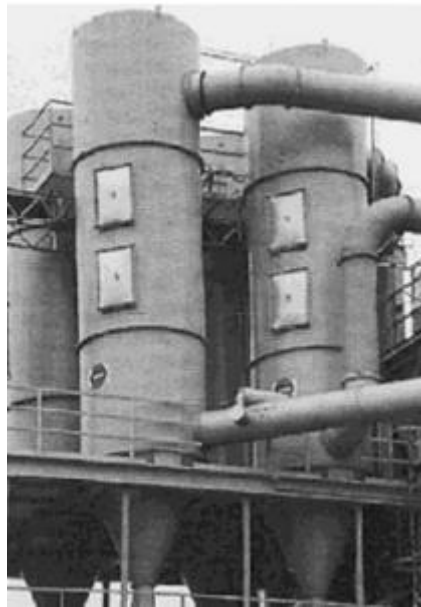
Figura 4.3.2.17 Panells de venteig instal·lats en dos equips
