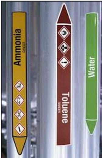
Figura 5.7.11.3.2 Exemple real de senyalització del fluid que circula per una canonada, indicant la naturalesa, estat i sentit de circulació.
