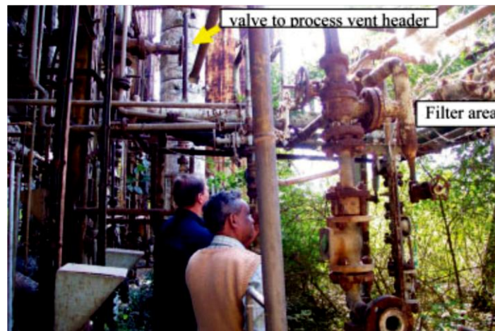
Figura 1.3.5.- Fotografia prop de l'àrea del filtre. Alguns dels components crítics s'identifiquen en la fotografia.
