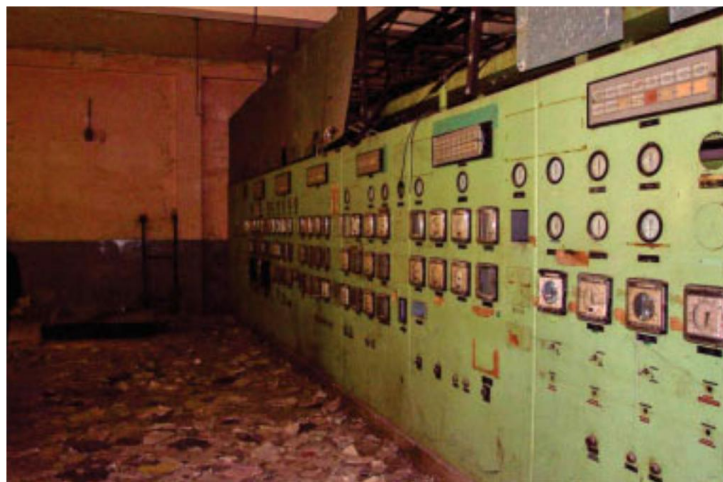
Figura 1.3.3.- Sala de control 20 anys després en la planta Union Carbide a Bhopal
