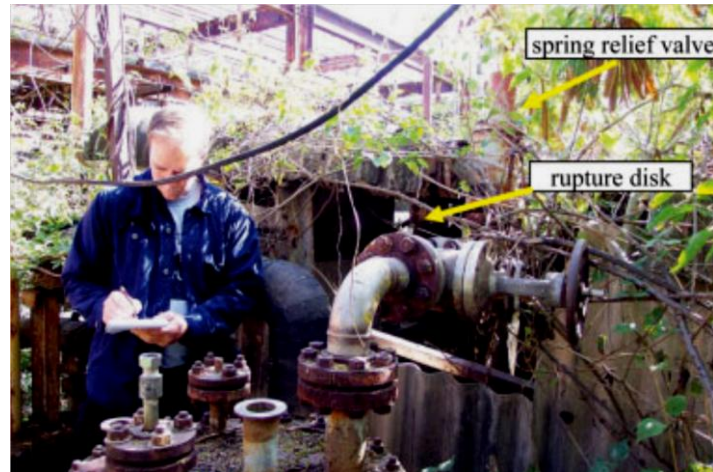
Figura 1.3.4.- Fotografia del Tanc 610 de la canonada d'entrada. Ruptura del disc al centre, i la vàlvula d'alleujament és darrere de la vegetació que ha crescut en els últims anys.
