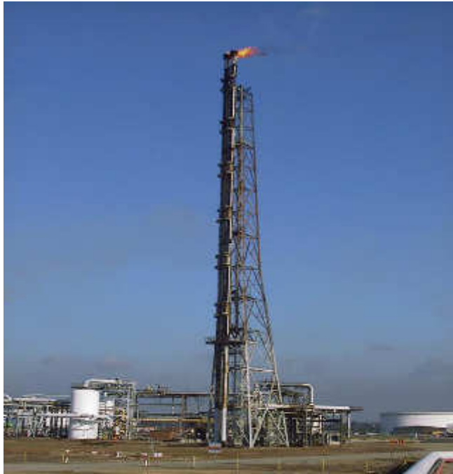
Figura 5.13.4-2. Antorcha tipo Derrick.
