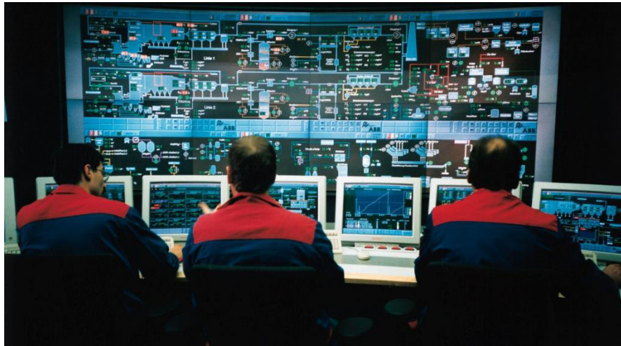
Figura 3.3. Sala de control.
